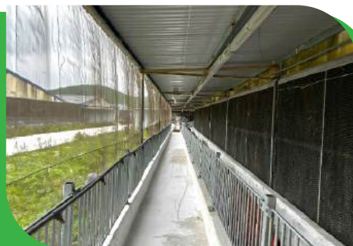
Hệ thống tấm làm mát (Cooling Pad) và lưới chắn côn trùng
